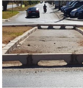
Obstrução de passagem irregular
