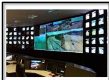
Controle de Tráfego
