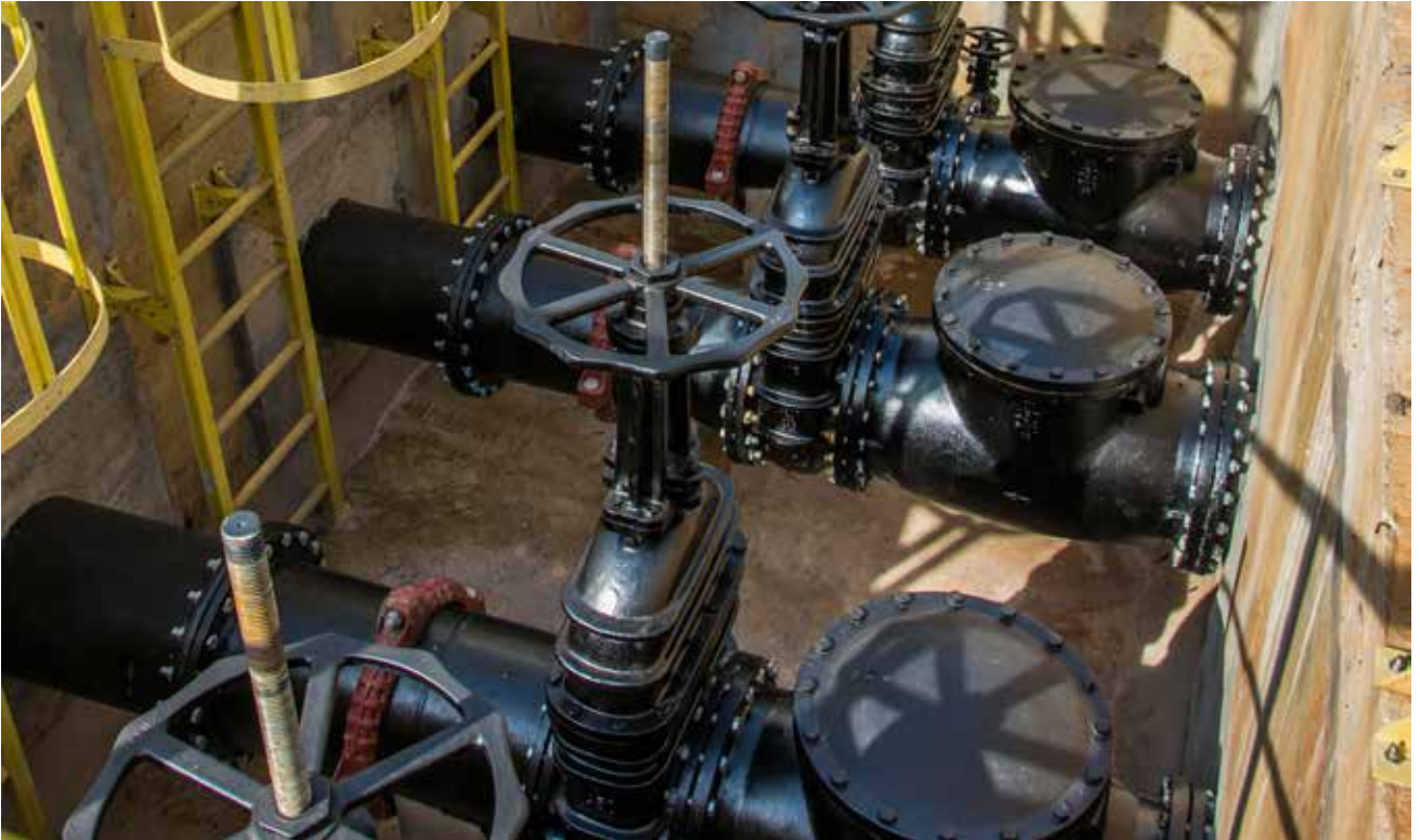
Fotos 1, 2 e 3: Estação de Tratamento de Esgotos Fonte: Arquivo fotográfico Procidades, BID
